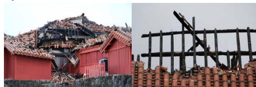
写真15 首里城火災跡 北殿 奉神門 (2019. 12. 21)
