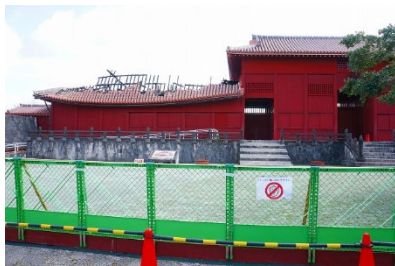
安全柵で囲まれた奉神門エリア 火災で壊れた赤瓦
