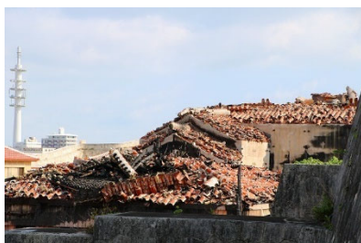
赤瓦が散乱する屋根の全体
