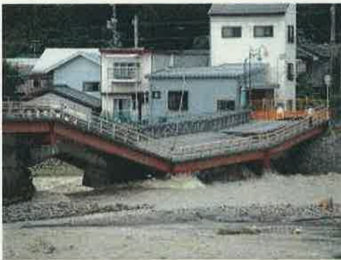
崩落する殿島橋
